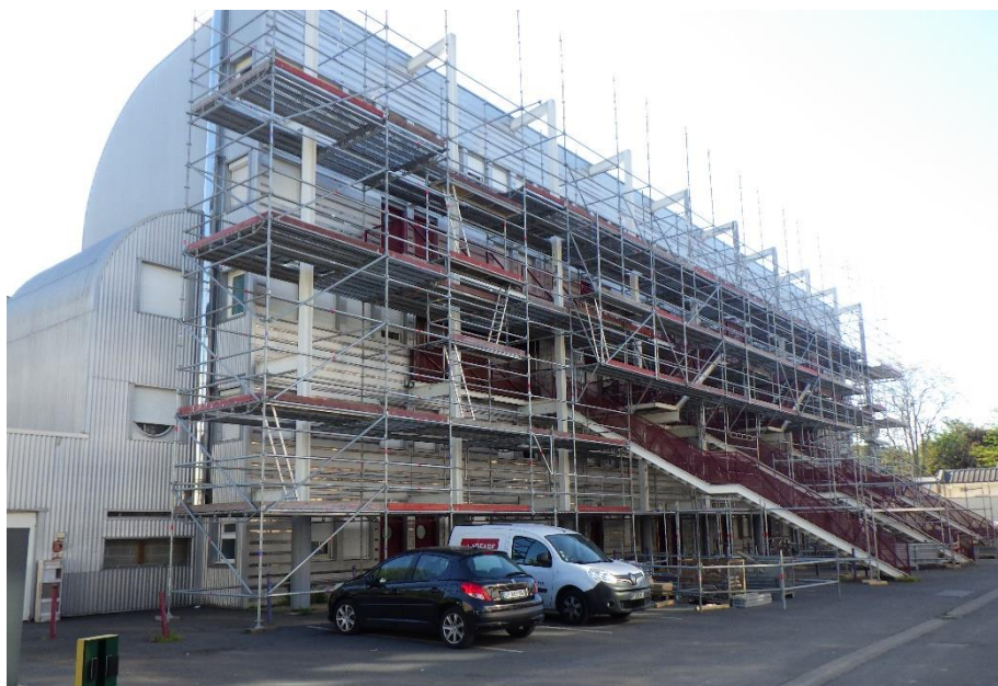
Grosses réparations (214 000€) sur l'immeuble 1
